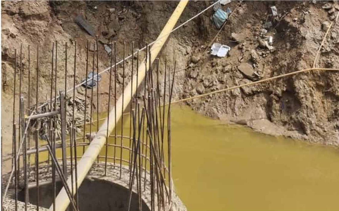
Muchas aguas residuales de las viviendas están cayendo a la zanja, provocando malos olores, afectando la salud de los residentes.
