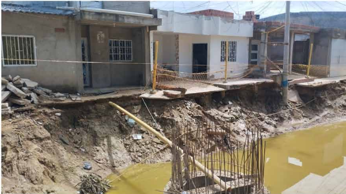
Impresionante hueco tiene afectados a cerca de 20 familias, quienes tienen casi preso a sus hijos, porque es un peligro salir al frente de la casa.
